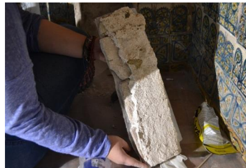
Figura 8. Extracción de bloque de azulejos con pérdida de adhesión con respecto al muro (Correa, S. 2016)
