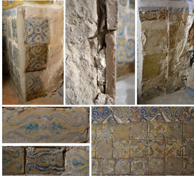
Figura 4. Estado de conservación de distintas secciones del guardapolvo y el piso. (Correa, S. 2016)
