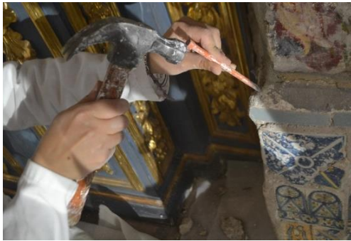
Figura 7. Desprendimiento de mortero de adhesión. (Marín, S. 2016)
