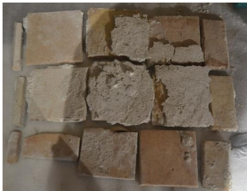
Figura 9. Vista general del reverso de azulejos del guardapolvo desprendidos (Correa, S. 2016)
