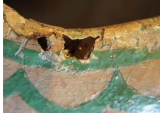
Figura 15 Pérdida de soporte por ataque xilófago.
