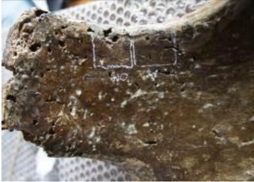
Figura 14 Ataque biológico, galerías y pasmado de la capa de protección
