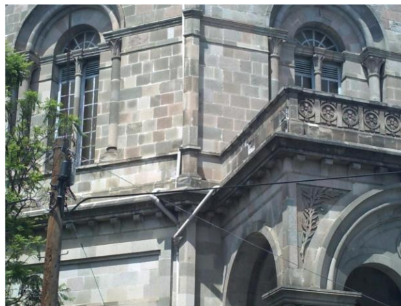
Fotografía 11. Destrucción de la fábrica de la Capilla de los Dolores. Toluca
