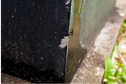
Fig. 24. Abrasiones y pérdida de recubrimiento.
